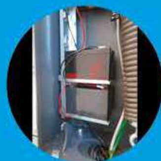
Batterie di emergenza
